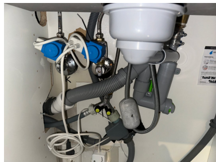
Røropplegg i kjøkkenbenk med Waterguard
