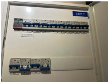
Sikringsskap med automatsikringer.
