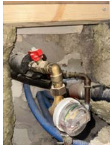
Stoppekraner plassert i luke på soverom
