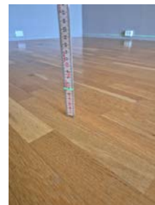
...til 5,9 cm 2 meter inn i stue, som er en høydeforskjell på 1,2 cm.
