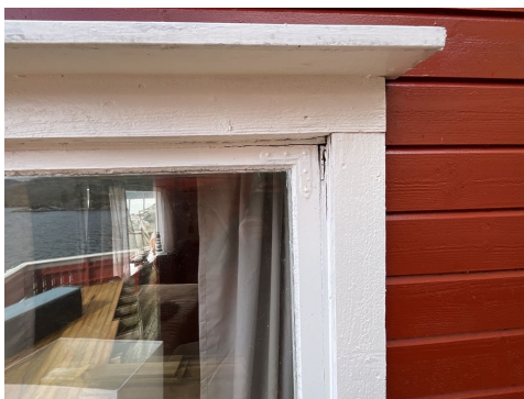
Bilde viser vindu med råteskade.
