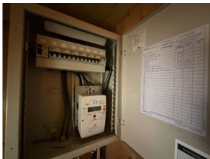
Sikringsskap plassert i bod.
