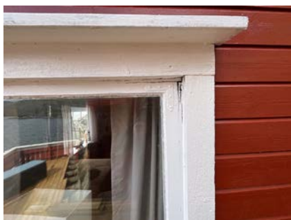
Bilde viser vindu med råteskade.
