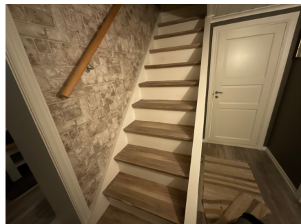
Trapp til kjeller som mangler rekkverk
