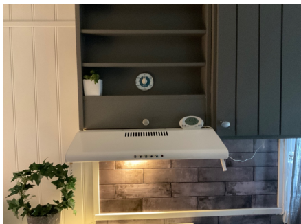
Mekanisk ventilator med avtrekk ut.
