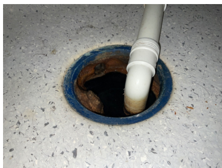
Eldre stålsluk i gulv.
