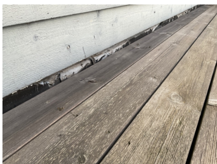
Ufagmessig utførelse av membran under terrassegulv.
