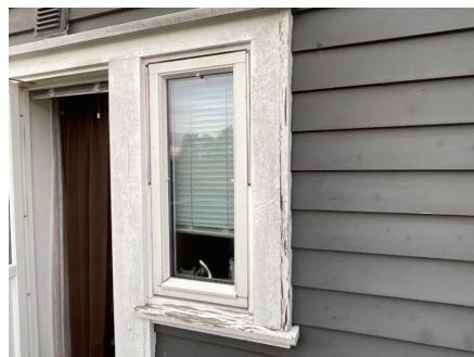
Malingsflass på belistning på vindu
