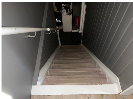
Trapp til 2. etg. som mangler håndrekke.
