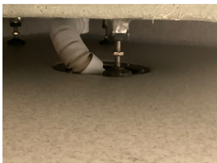
Sluk under dusjkabinett
