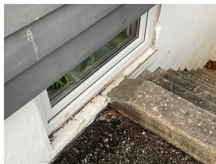
Mangelfull innpussing av kjellervindu
