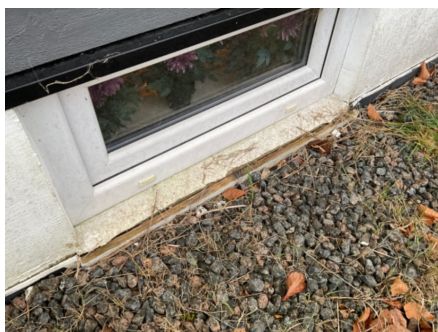
Mangelfull innpussing av kjellervindu.
