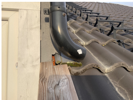
Ufagmessig utførelse av utvendig kledning
