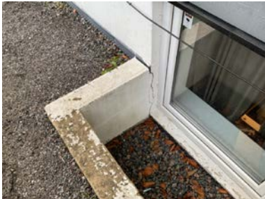
Sprekk mellom grunnmur og lysgrav
