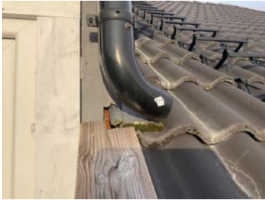
Ufagmessig utførelse av utvendig kledning
