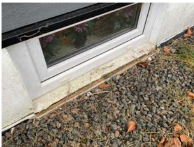
Mangelfull innpussing av kjellervindu.
