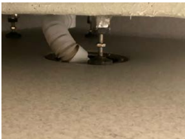
Sluk under dusjkabinett
