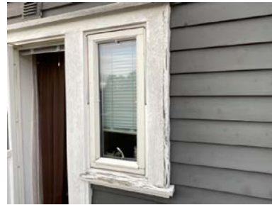
Malingsflass på belistning på vindu
