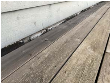
Ufagmessig utførelse av membran under terrassegulv.
