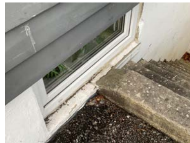
Mangelfull innpussing av kjellervindu
