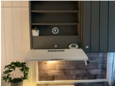
Mekanisk ventilator med avtrekk ut.
