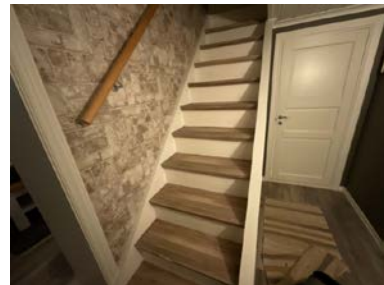
Trapp til kjeller som mangler rekkverk
