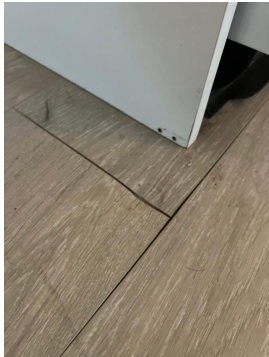
Skade i laminat der kjøleskapet har stått
