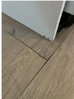
Skade i laminat der kjøleskapet har stått
