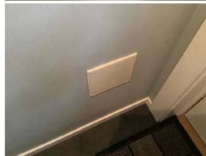
Stoppekran bak luke i entré i følge selger.
