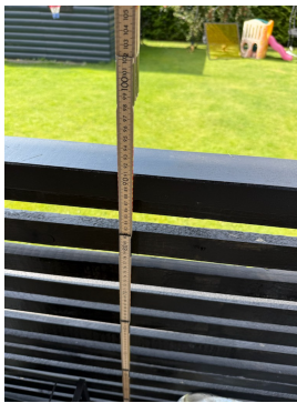
Rekkverkshøyde ved vestvendt terrasse
