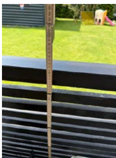
Rekkverkshøyde ved vestvendt terrasse
