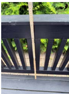
Rekkverkshøyde ved inngangsparti
