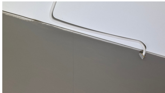
Kabler er ikke tilfredsstillende festet.
