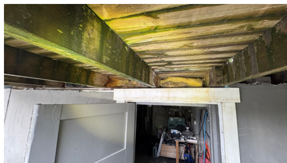
Det er manglende membran/tettesjikt over kjellerrom.
