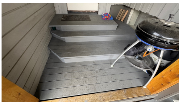
Trappen har noe slitasje.
