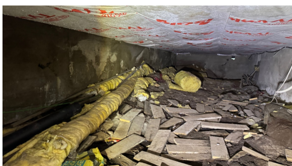
Organiske materialer lagret i krypkjeller er råteskadet.
