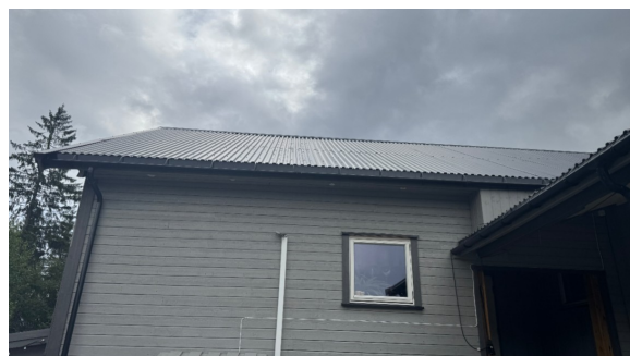
Det mangler snøfangere på hele eller deler av taket, noe som var krav på byggemeldingstidspunktet.
