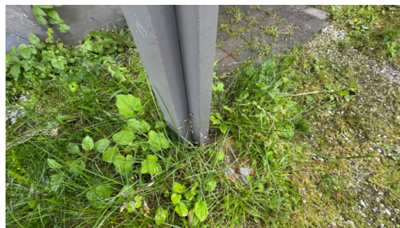
Søyle montert direkte på bakken er løs.
