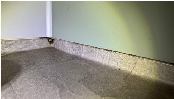
Det er registrert misfarging og begynnende sopp/muggvekst i dusjsonen.
