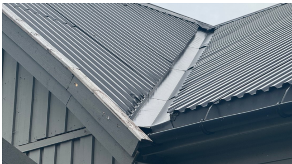
Det er registrert bulker i taktekke.
