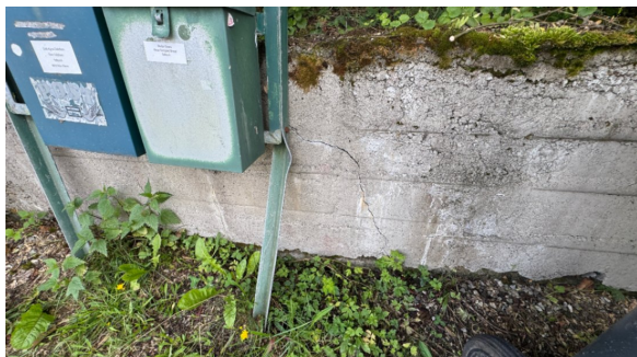
Det er påvist sprekker i forstøtningsmuren.
