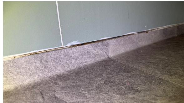
Det er registrert misfarging og begynnende sopp/muggvekst i dusjsonen.
