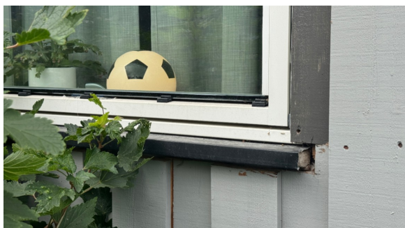
Utvendig beslag/tetningslist i nedkant på vinduet mangler.
