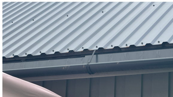
Det er registrert noe rust i nedkant av taktekke.
