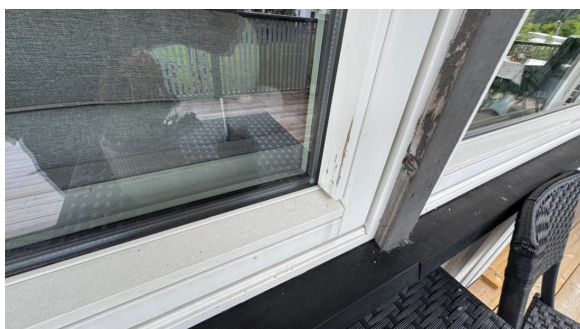
Enkelte vinduer er noe utvendig værslitt.
