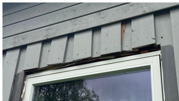
Det er påvist avvik rundt innsettsdetaljer.
