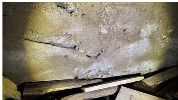
Grunnmuren har sprekkdannelser.
