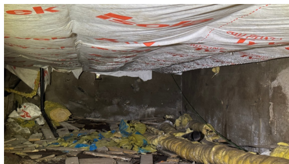
Det er registrert mye kondens/vanndråper i etasjeskille.
