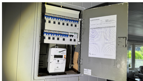
Kontroll av el-skap og kursfortegnelse.
