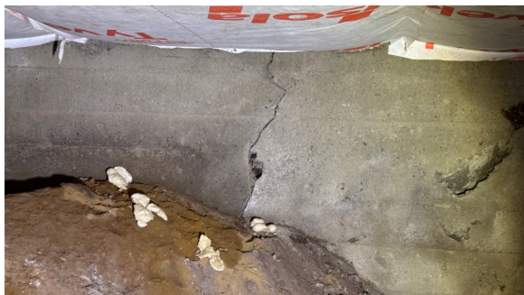
Grunnmuren har sprekkdannelser.
