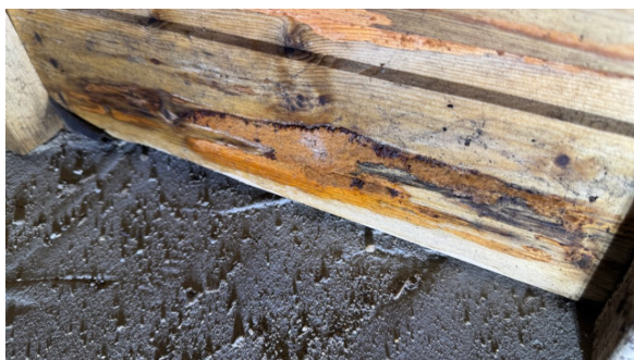
Det er registrert soppevekst på panel i kjelleretasjen.
