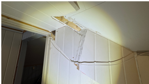
Kabler er ikke tilfredsstillende festet.
