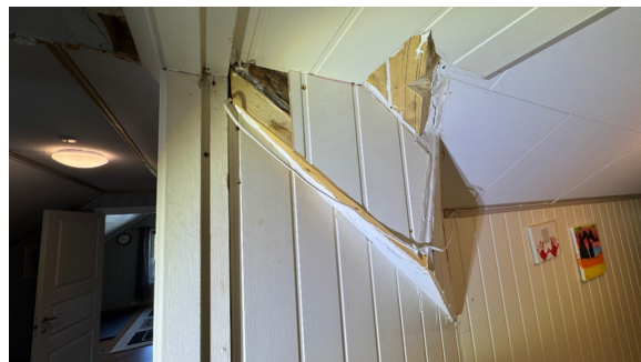
Det er noe ufagmessig utførelse på enkelte overflater.
