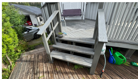
Trappen har noe slitasje.
