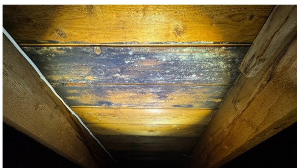
Stedvis svertesopp i takkonstruksjonen.
