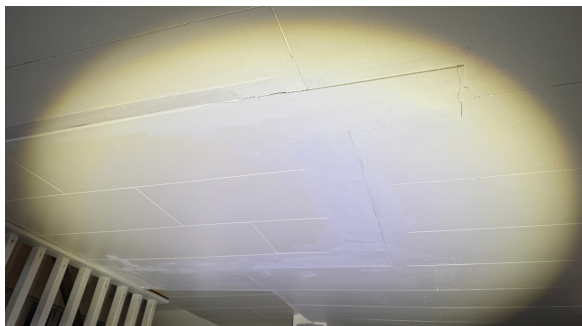
Det er merker i himlingen etter tidligere vegger.
