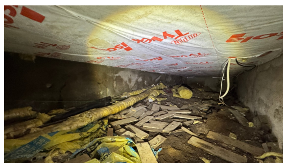
Det er manglende fuktsperre på bakken.
