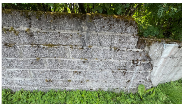
Det er påvist sprekker i forstøtningsmuren.
