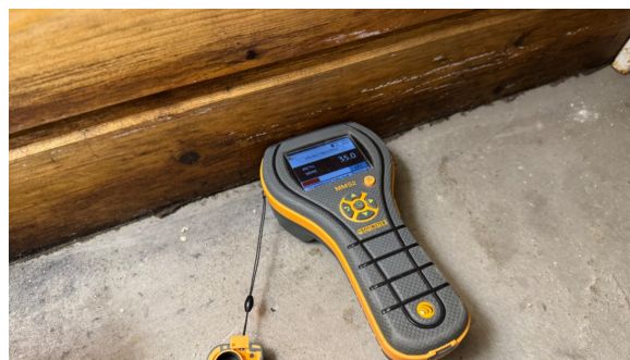
Det er målt forhøyede fuktverdier/råteskader i panel.
