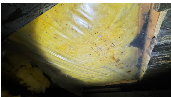
Det er registrert spor etter skadedyr/mus i etasjeskiller.
