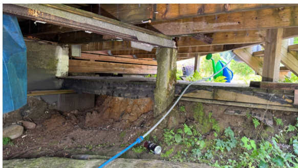
Betongsøyle bør skiftes ut.
