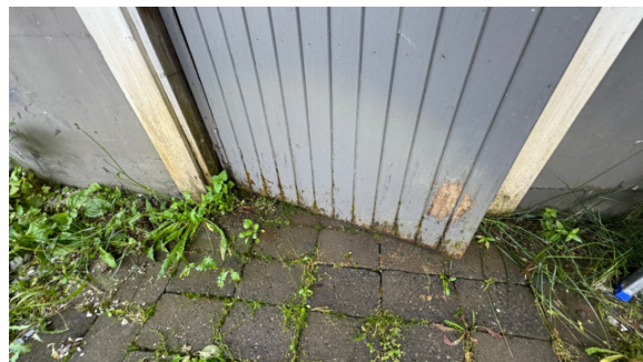
Enkelte dører er utvendig værslitt.
