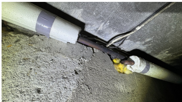
Det er påvist at vannrør som er utsatt for kulde har mangelfull isolering.
