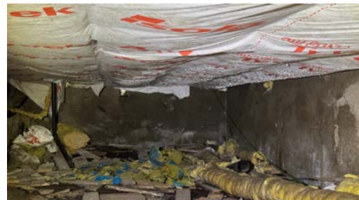
Det er registrert mye kondens/vanndråper i etasjeskille.
