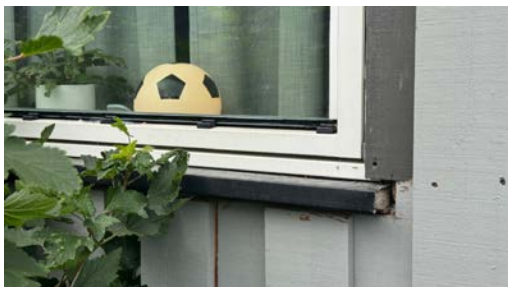
Utvendig beslag/tetningslist i nedkant på vinduet mangler.
