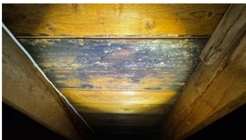
Stedvis svertesopp i takkonstruksjonen.
