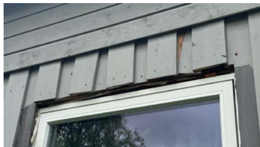
Det er påvist avvik rundt innsettsdetaljer.
