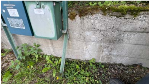
Det er påvist sprekker i forstøtningsmuren.
