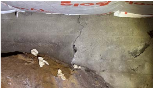
Grunnmuren har sprekkdannelser.
