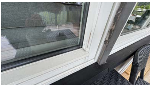
Enkelte vinduer er noe utvendig værslitt.
