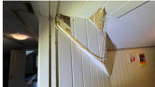
Det er noe ufagmessig utførelse på enkelte overflater.
