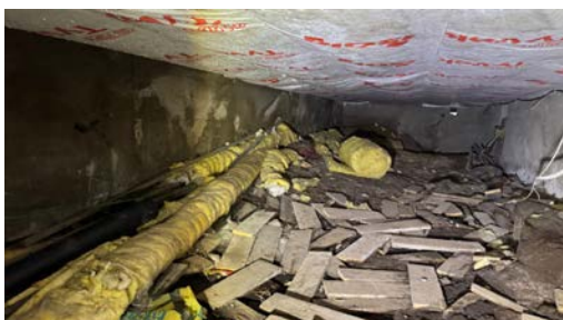
Organiske materialer lagret i kryp kjeller er råteskadet.
