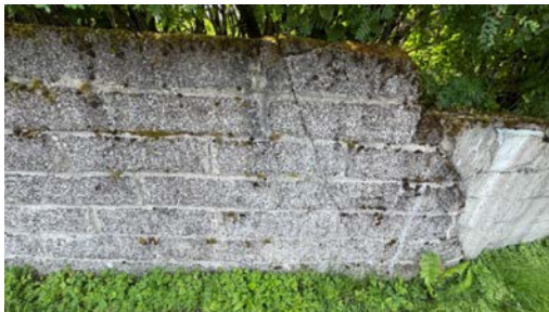
Det er påvist sprekker i forstøtningsmuren.
