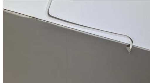
Kabler er ikke tilfredsstillende festet.
