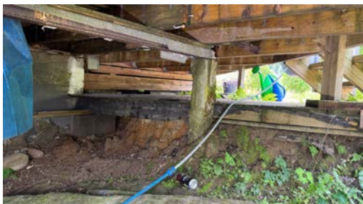
Betongsøyle bør skiftes ut.
