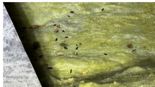
Det er registrert spor etter skadedyr/mus.
