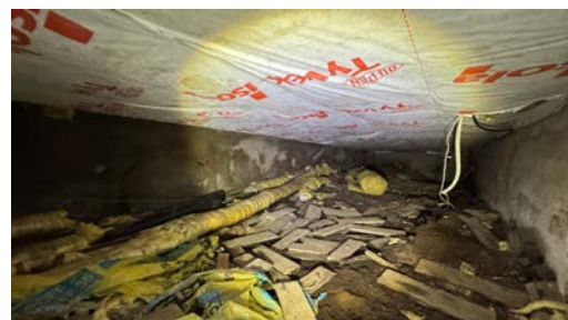
Det er manglende fuktsperre på bakken.
