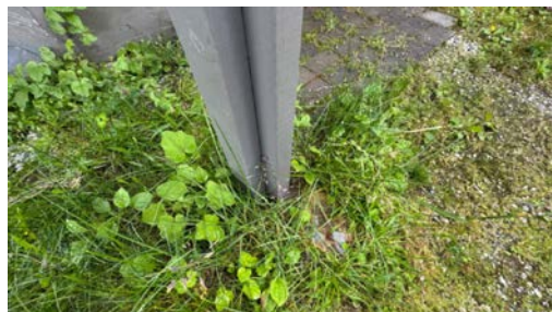
Søyle montert direkte på bakken er løs.
