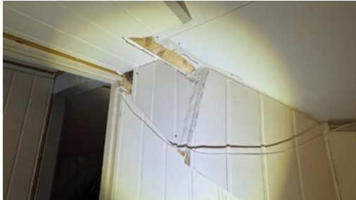
Kabler er ikke tilfredsstillende festet.
