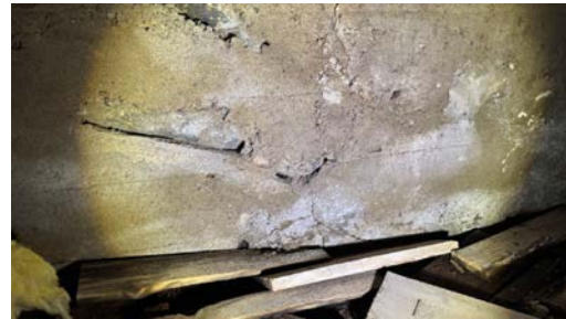
Grunnmuren har sprekkdannelser.
