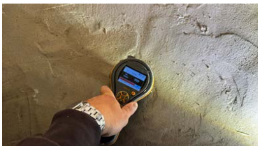
Det er ingen fuktsperre mot grunnen i den støpte sålen.
