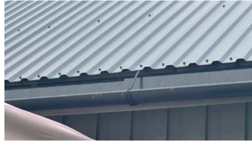
Det er registrert noe rust i nedkant av taktekke.
