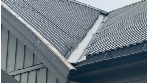
Det er registrert bulker i taktekke.
