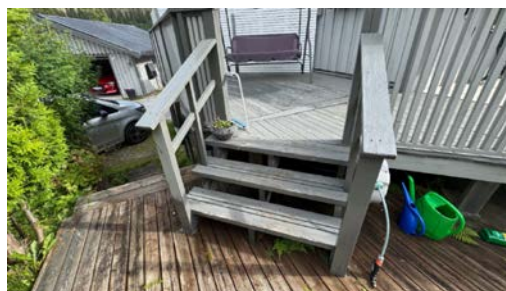
Trappen har noe slitasje.
