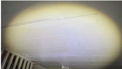
Det er merker i himlingen etter tidligere vegger.
