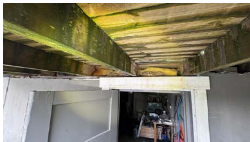
Det er manglende membran/tettesjikt over kjellerrom.
