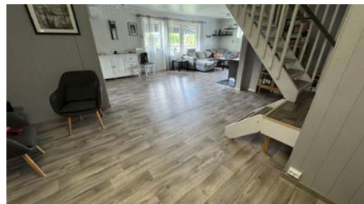
Største målte planavvik er målt i stuen.
