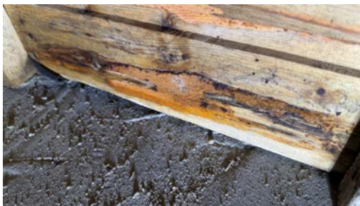
Det er registrert soppvekst på panel i kjelleretasjen.
