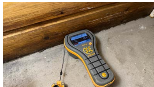
Det er målt forhøyede fuktverdier/råteskader i panel.
