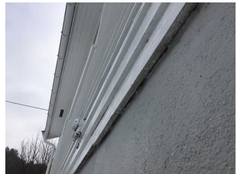
Mangelfull lufting bak kledning
