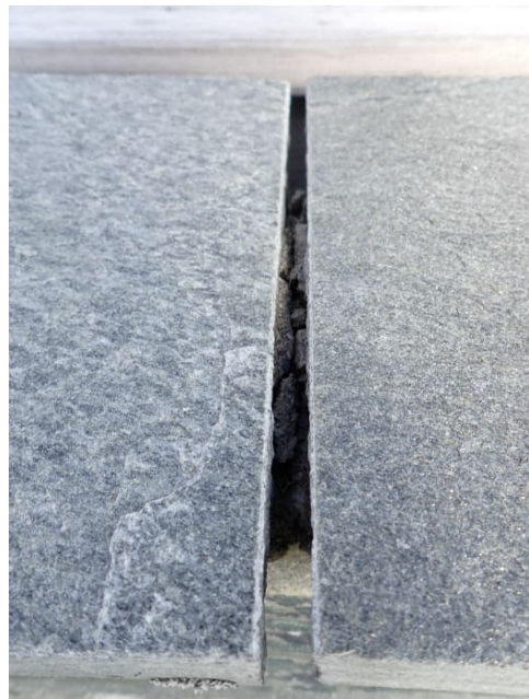
Fugemasse som har løsnet og blitt borte.
