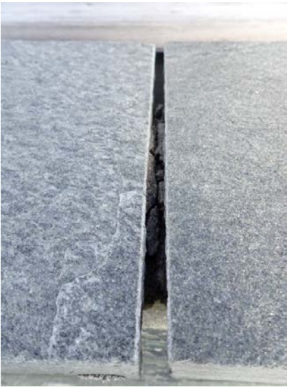
Fugemasse som har løsnet og blitt borte.
