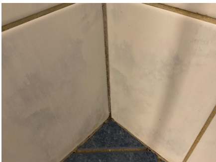
Svarte sopp i silikonfuger
