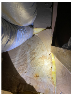
Fuktmerker ved takgjennomføringer
