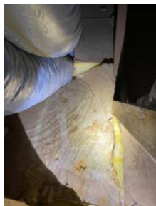
Fuktmerker ved taggjennomføringer
