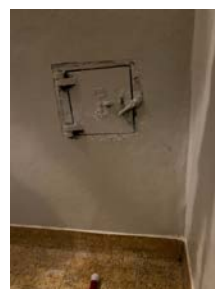
Sotluke - ikke noe avrenningsmerker
