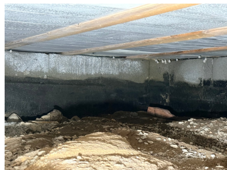
Kondensering innvendig ringmur, kokonger i etasjeskiller.
