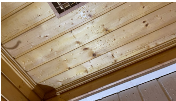
Kondens i himling ved dør til krypkjeller
