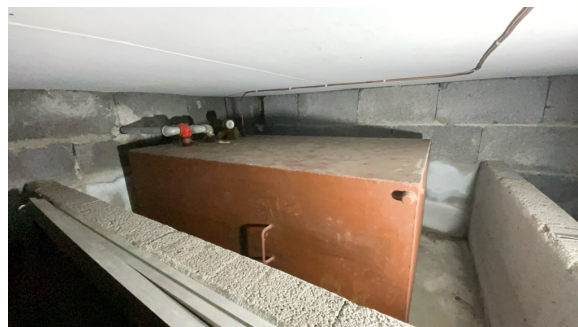
Tank i krypkjeller.
