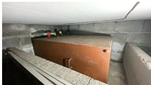
Tank i krypkjeller.
