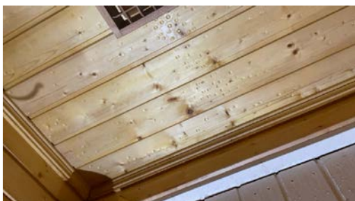
Kondens i himling ved dør til krypkjeller
