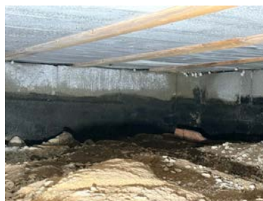
Kondensering innvendig ringmur, kokonger i etasjeskiller.
