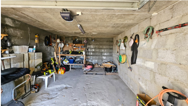
Saltutslag i garasje.
