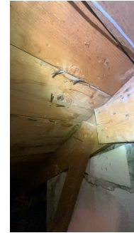
Spiker stikker gjennom undertak enkelte steder.
