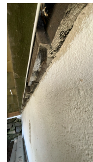
Utvendig kledning har begrenset med lufting.
