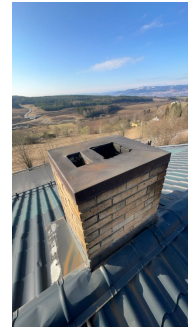
Pipe anbefales helbeslått over tak.
