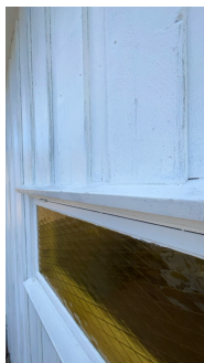
Kledning er ført ned på vannbrett, risiko for fuktopptrekk.
