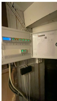
Sikringskap for underetasje plassert i bod.
