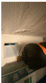
Sprekker/riss ble registrert på grunnmur.
