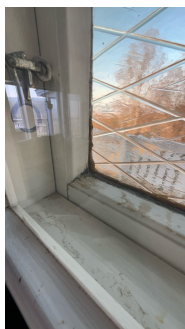
Kondensmerker på enkelte vinduer.
