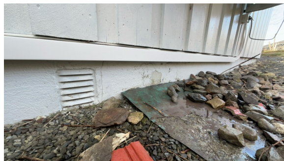
Småskader på grunn av fuktbelastning over tid.
