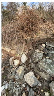
Det er påvist mindre sprekker og/eller skjevheter i muren.
