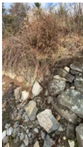
Det er påvist mindre sprekker og/eller skjevheter i muren.
