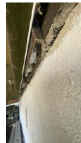
Utvendig kledning har begrenset med lufting.
