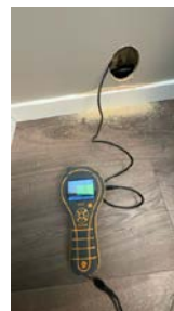
Hulltaking foretatt på soverom. Fuktmåling ble foretatt, jeg målte tørre verdier i konstruksjon.
