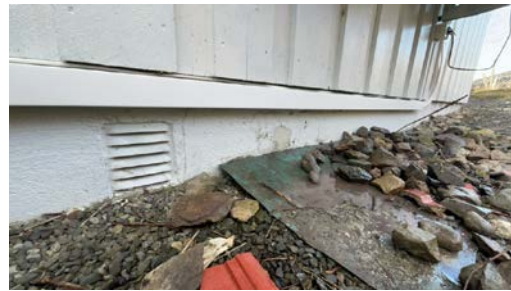
Småskader på grunn av fuktbelastning over tid.
