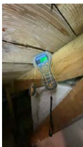
Synlige fuktmerker. Ved enkel fuktmåling registrerte jeg tørre verdier.
