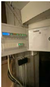
Sikringskap for underetasje plassert i bod.
