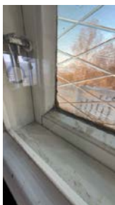
Kondensmerker på enkelte vinduer.
