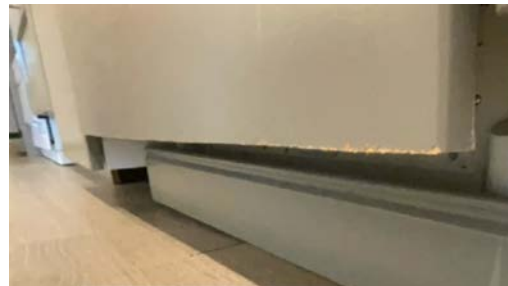
Punktskader på innredning.
