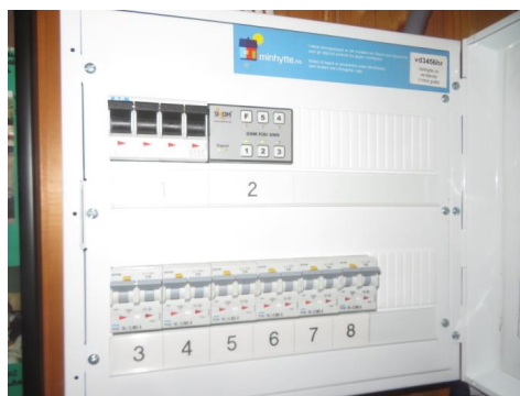
Sikringsskap på vegg i vindfang.
