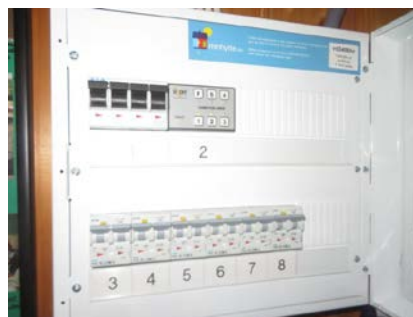
Sikringsskap på vegg i vindfang.
