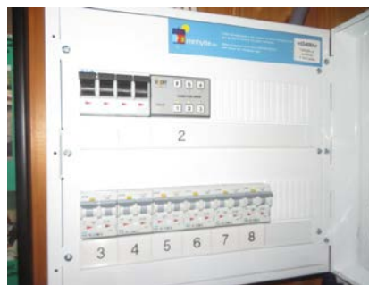
Sikringsskap på vegg i vindfang.
