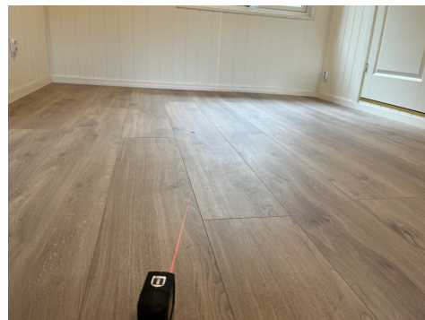
Større skjevheter på gulv og vegger.
