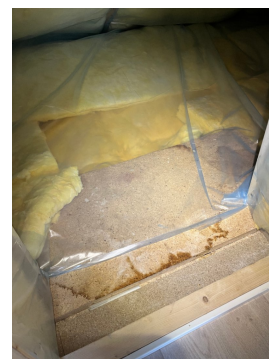
Fuktmerker på plate ved luke til kneloft.
