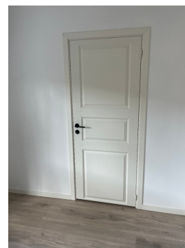
Dør loftetasje er kuttet i nedkant.
