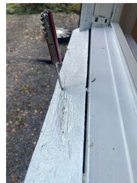
Råte i vannbrett og ikke tett mot vindu.
