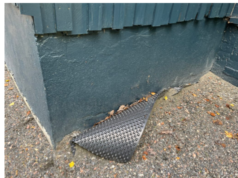
Grunnmursplast må utbedres.
