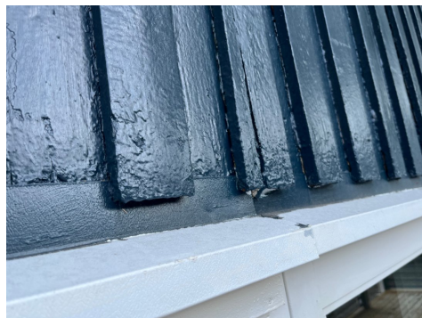
Vannbrettbeslag over vindu/dør er montert feil og skal være bak kledningen.
