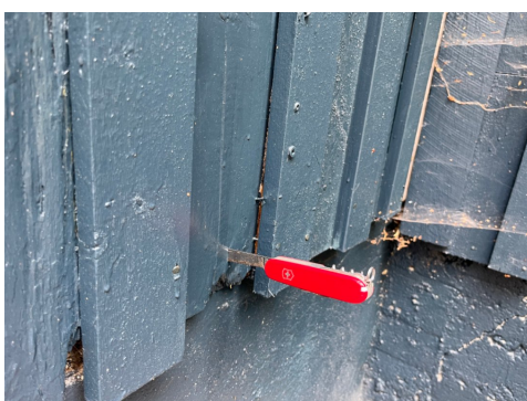
Råteskade i kledning.
