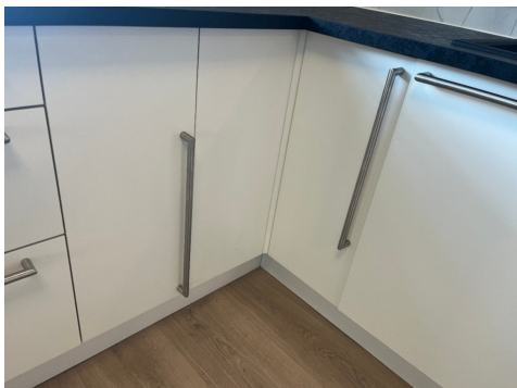
Håndtak er feil montert.
