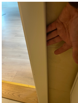
Dørlist på bad er ikke inntil vegg.
