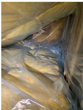
Plast og isolering må utbedres på kneloft.
