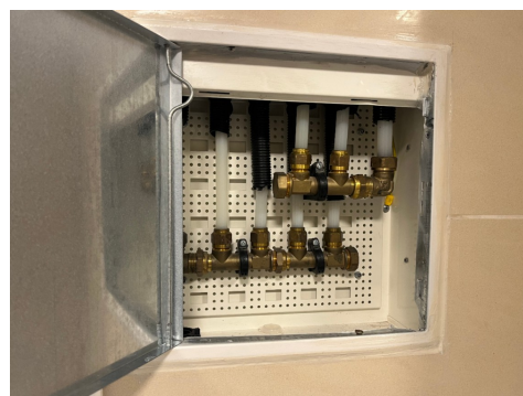
Fordeleskap for vann på bad.
