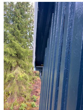
Gesimser og vindskier har skader.
