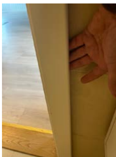
Dørlist på bad er ikke inntil vegg.
