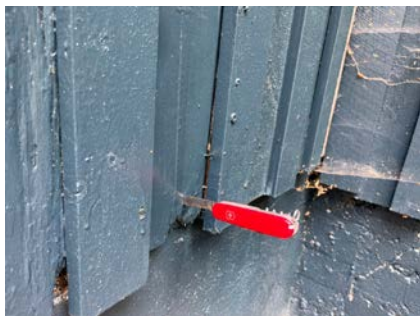
Råteskade i kledning.
