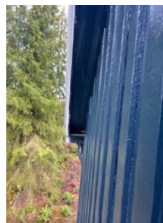
Gesimser og vindskier har skader.
