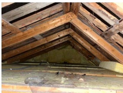
Møneloft uten ventilering.
