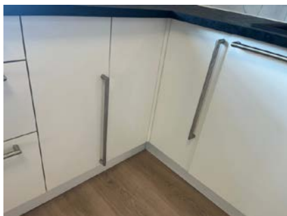
Håndtak er feil montert.
