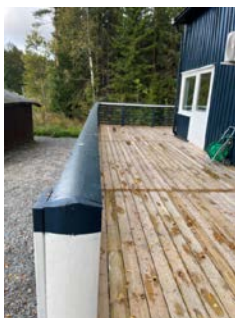
Veranda har skjevheter og er ikke faglig utført.
