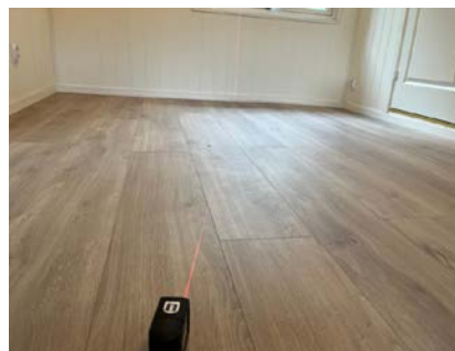
Større skjevheter på gulv og vegger.
