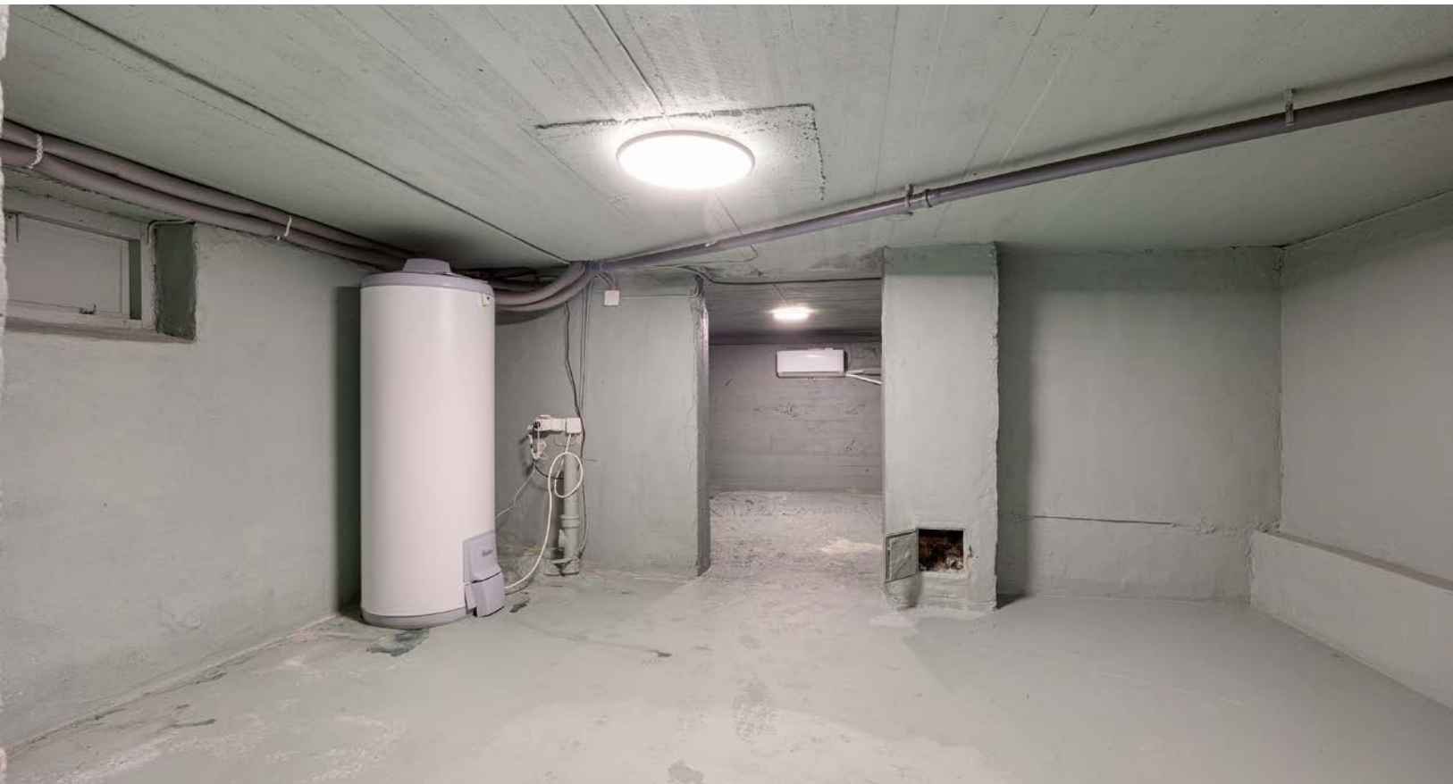
I tillegg til toalettrommet så består kjelleren av boder. I den ene boden er varmtvannsberederen plassert. I den andre boden er det montert luft-til-luft varmepumpe.
