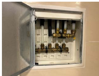
Forderskap for vann på bad.
