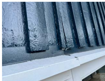
Vannbrettbeslag over vindu/dør er montert feil og skal være bak kledningen.
