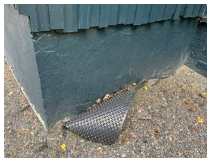
Grunnmursplast må utbedres.
