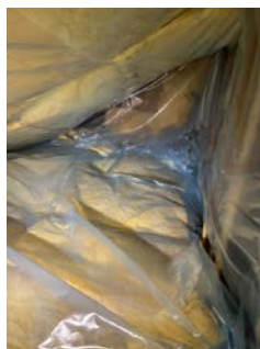
Plast og isolering må utbedres på kneloft.
