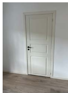
Dør loftetasje er kuttet i nedkant.
