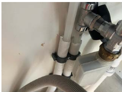
Manglende tettemuffer på varerør i kjøkkenskap.
