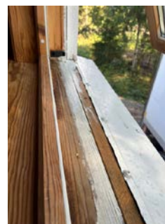
Vannbrettbeslag under vinduer er montert feil og er ikke ført under vinduskarm.
