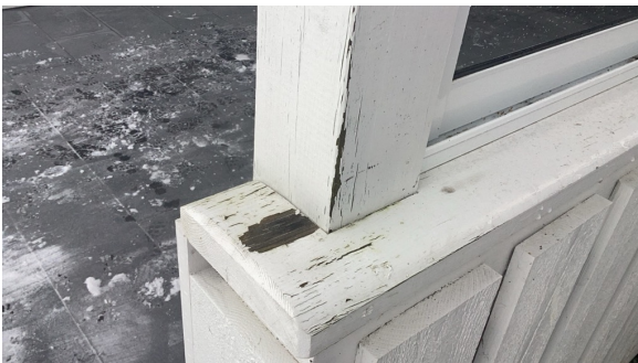
Eksempel på slitasje på rekkverk ved entre
