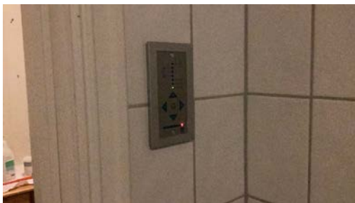
Styringspanel for ventilasjon på bad.
