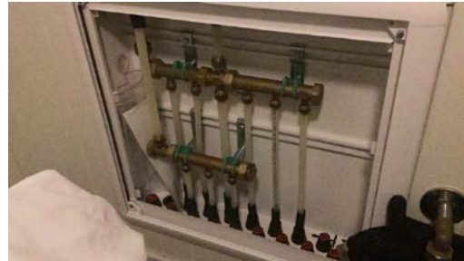
Fordelerskap for vannrør.
