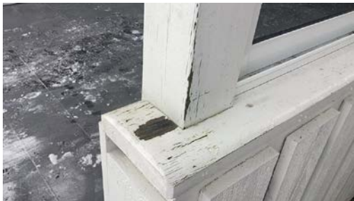
Eksempel på slitasje på rekkverk ved entre
