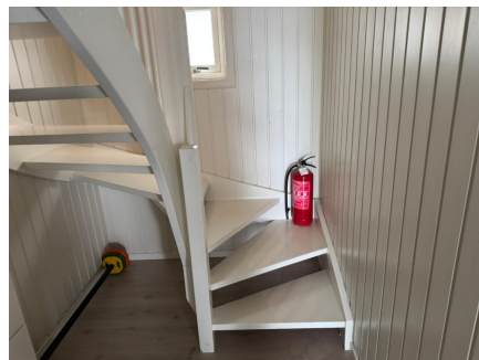
Det er ikke montert håndløper i trappen.
