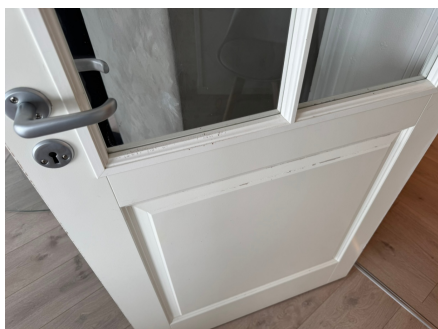
Skader på innvendig dør.
