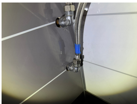
Rør bak dusjkabinettet er ikke fuget.
