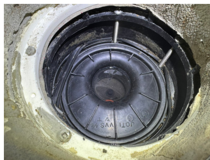
Pakning til slukforlenger er løs.
