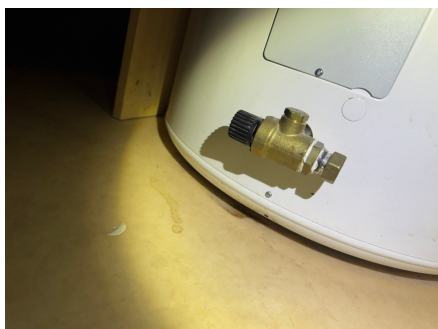
Det er ikke tilfredsstillende avrenning fra varmtvannstanken.
