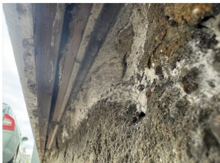
Det er ikke montert musesperre i nedkanten kledningen.
