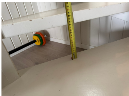
Åpninger mellom trinn.
