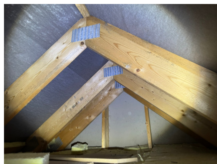
Svertesopp på sperre.
