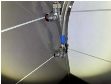
Rør bak dusjkabinettet er ikke fuget.
