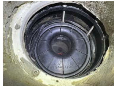
Pakning til slukforlenger er løs.
