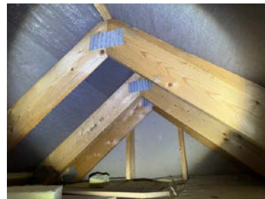
Svertesopp på sperre.
