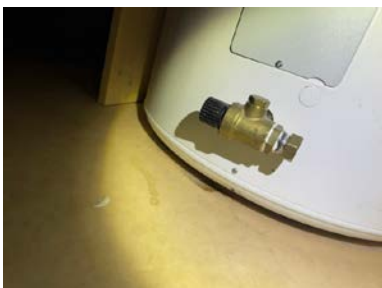
Det er ikke tilfredsstillende avrenning fra varmtvannstanken.
