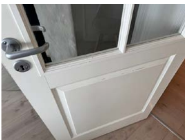
Skader på innvendig dør.
