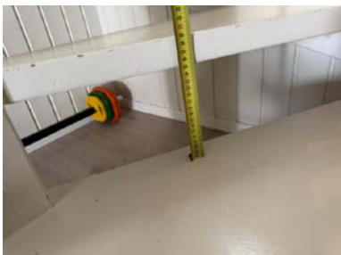
Åpninger mellom trinn.
