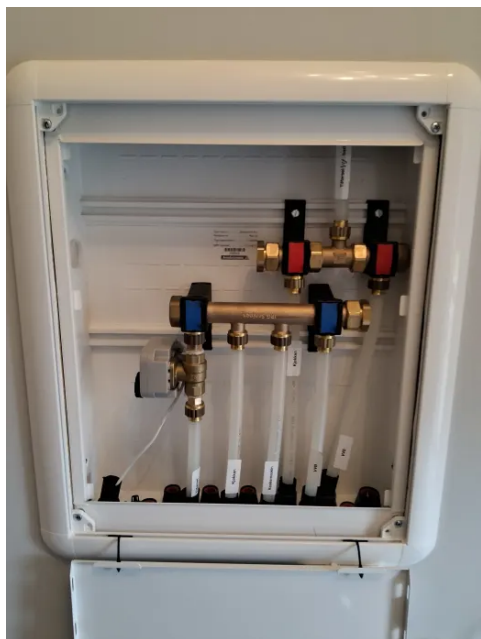
Leiligheten har vannrør av typen rør-i-rør.
