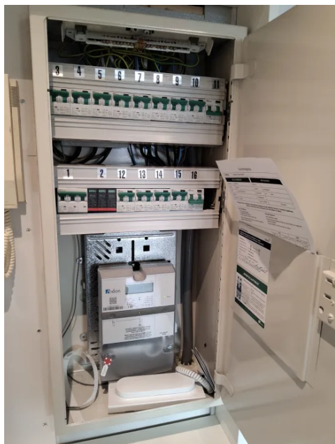
Sikringsskap med automatsikringer er plassert i gang.
