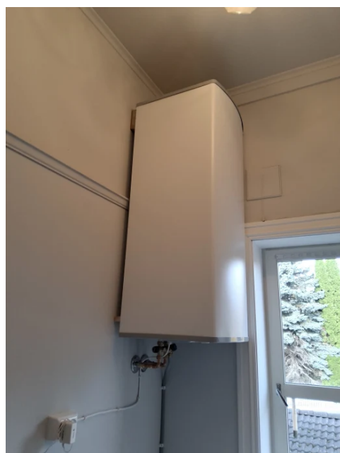
Vegghengt varmtvannsbereder er plassert på teknisk rom/vaskerom.
