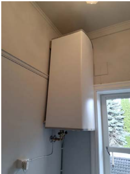
Vegghengt varmtvannsbereder er plassert på teknisk rom/vaskerom.
