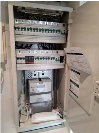
Sikringsskap med automatsikringer er plassert i gang.
