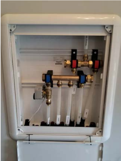
Leiligheten har vannrør av typen rør-i-rør.
