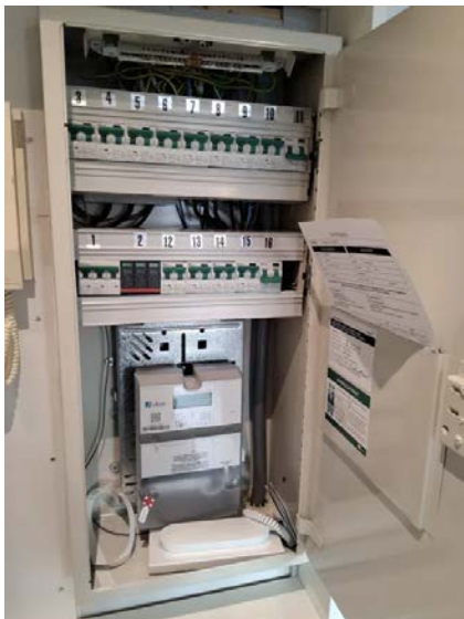
Sikringsskap med automatsikringer er plassert i gang.
