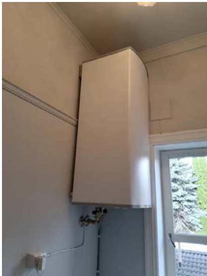
Vegghengt varmtvannsbereder er plassert på teknisk rom/vaskerom.
