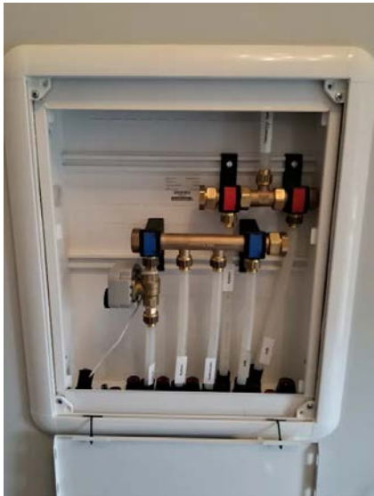
Leiligheten har vannrør av typen rør-i-rør.
