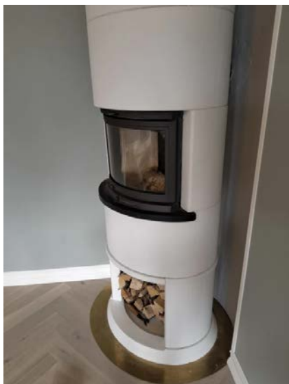
Det er etablert for liten ubrennbar plate på gulv foran ovn.
