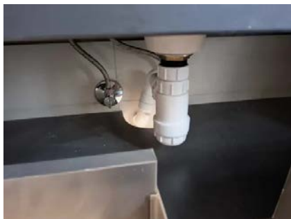
Leiligheten har synlige avløpsrør av plast.
