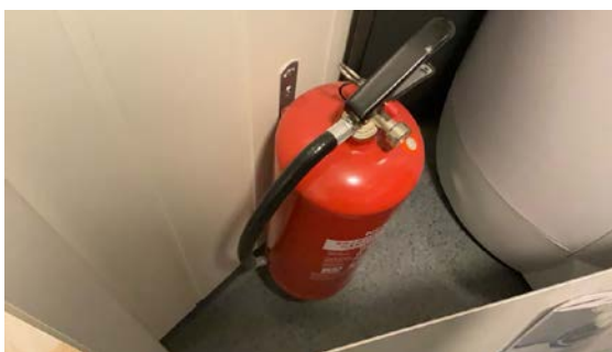
Brannslukningsapparat henger i bod.
