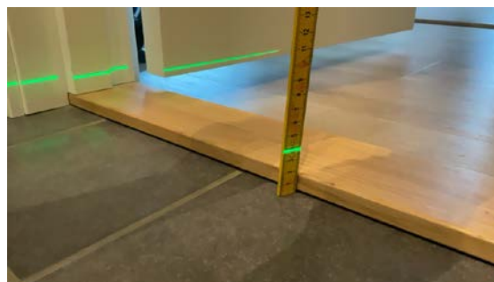
Det er målt 4cm på gulv ved terskel.
