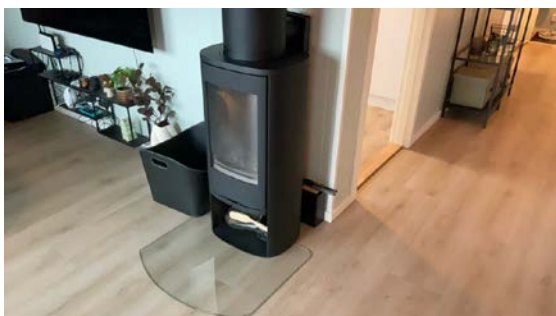
Ildsted med stålpipes.
