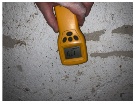
Noe fuktsøkutslag nederst på grunnmur
