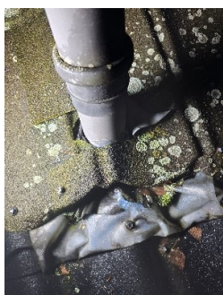
Ikke tilfredstillende rørgjennomføring
