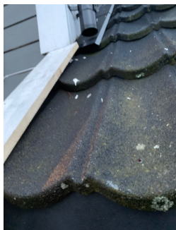
En av flere uheldige overganger
