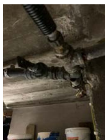
Eldre hovedstoppekran, plassert i kjeller
