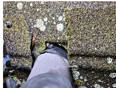
Ikke tilfredstillende rørgjennomføring
