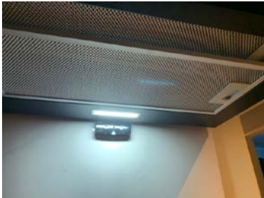
Synlig komfyrvakt (ikke funksjonstestet)
