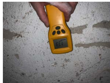
Noe fuktskutslag nederst på grunnmur
