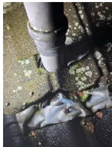
Ikke tilfredstillende rørgjennomføring
