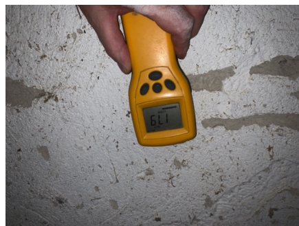
Noe fuktsøkutslag nederst på grunnmur
