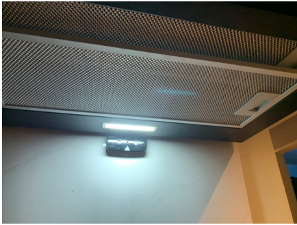
Synlig komfyrvakt (ikke funksjonstestet)
