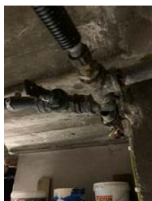
Eldre hovedstoppekran, plassert i kjeller
