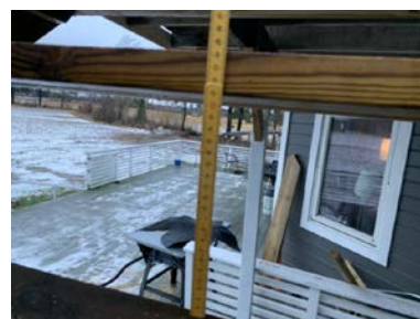
For høyt opptrinn og for stor avstand mellom trinnene
