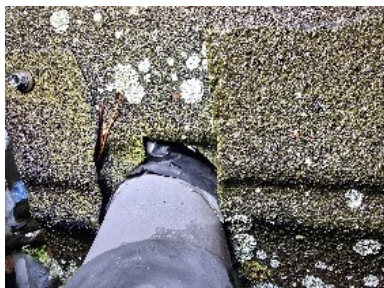
Ikke tilfredsstillende rørgjennomføring
