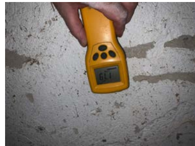
Noe fuktsøkutslag nederst på grunnmur
