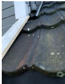
En av flere uheldige overganger
