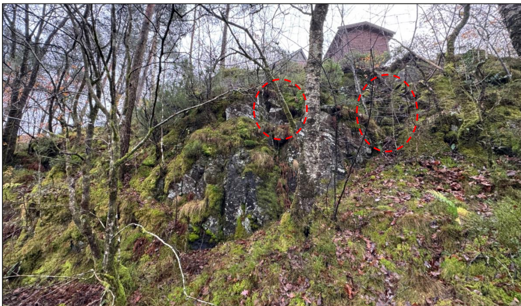
Figur 5: En skrent nordvest i kartleggingsområdet. Enkelte potensielt sprekkeavgrensede bergblokker er angitt i rødt.
