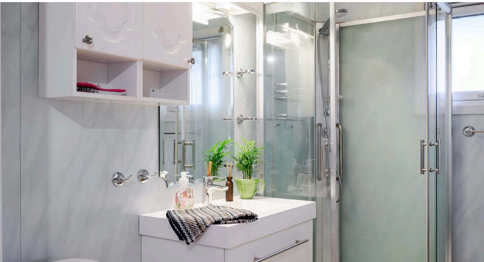
Boligen har et lyst eldre badrom antatt fra 1990-tallet. Baderommet har fått TG3 i tilstandsrapporten og må oppgraderes for å tåle normal bruk etter dagens krav.
