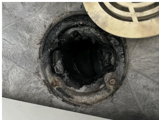
Våtrommets tettesjikk/ membran på gulv står foran utbedring/ utskifting.
