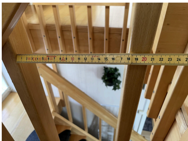
Åpninger i rekkverk ikke iht. krav.
