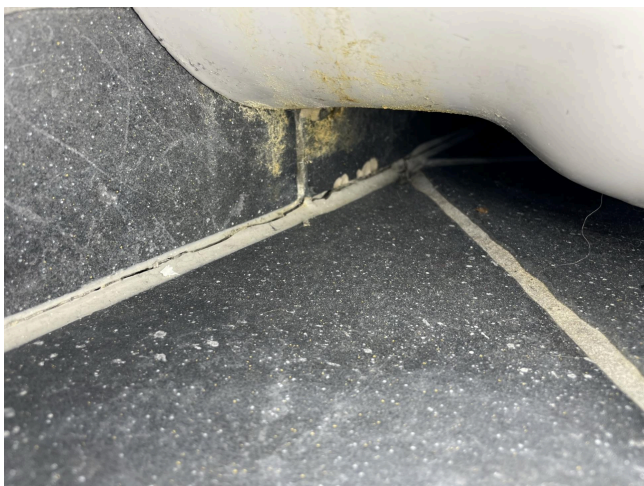
Oppsprukket fug mellom gulvflis og sokkelflis.
