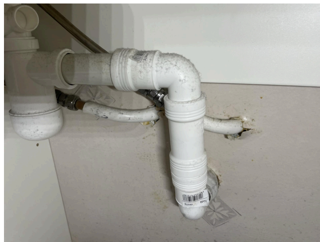
Gjennomføringer i våtsone vegg vask og dusjsone er ikke korrekt utført.
