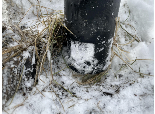
Takvann føres rett ned på terreng ved mur.
