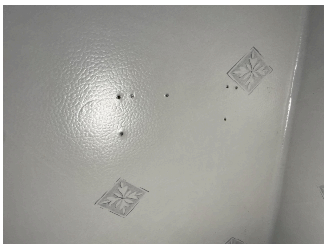
Det er registrert mindre skader på overflater som hull og spiker.
