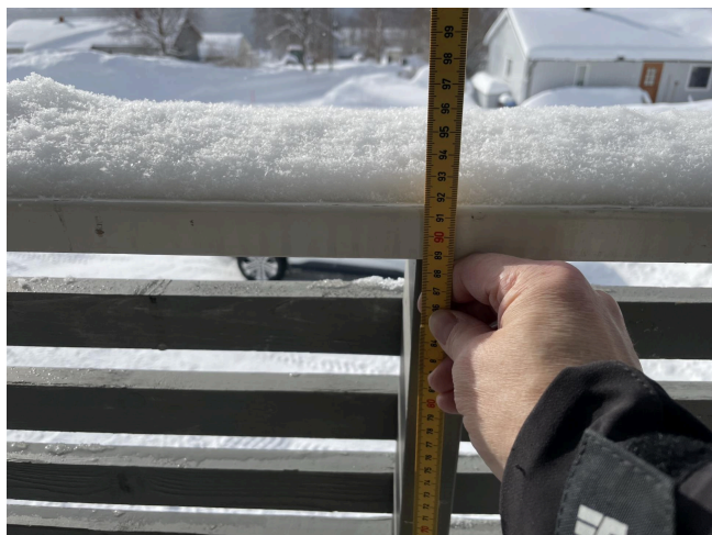
Rekkverk på balkong utenfor stue har ikke høyde som tilfredsstillers dagens krav.
