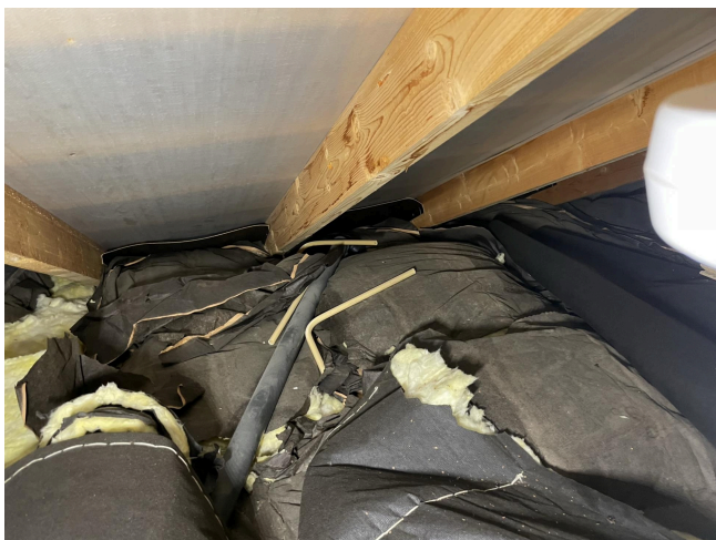
Taket er dårlig isolert.
