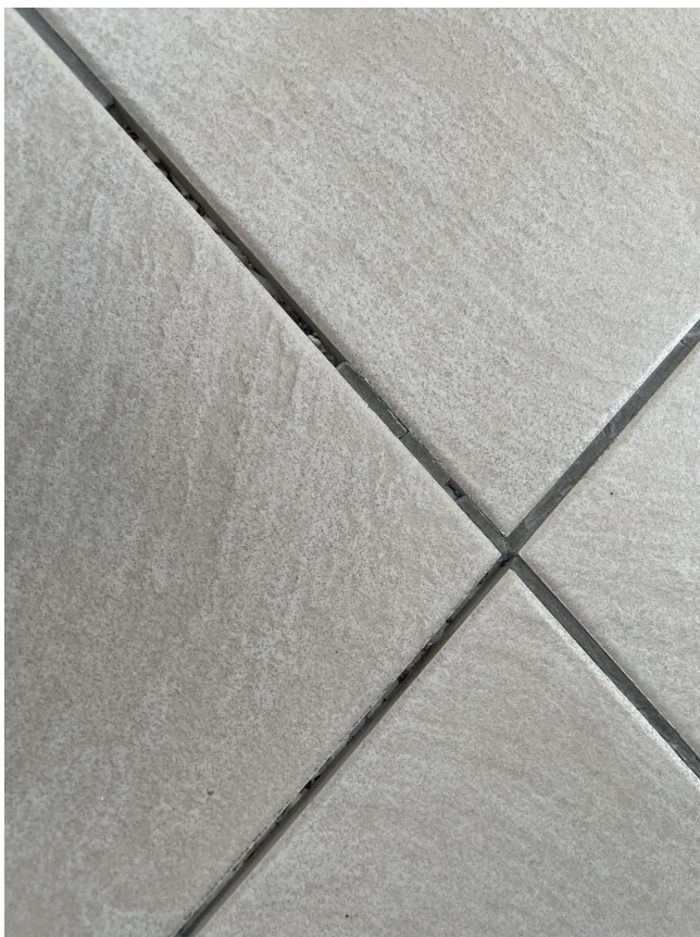
Keramiske fliser i vindfang har løse fuger og hulrom.
