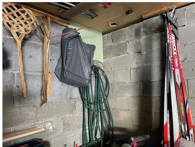
Lecavegg i garasje har manglende overflatebehandling.
