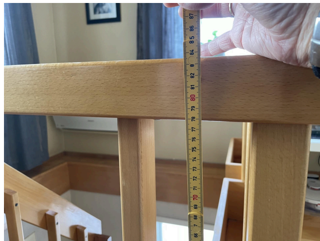
Høyde av rekkverk ikke iht. krav.
