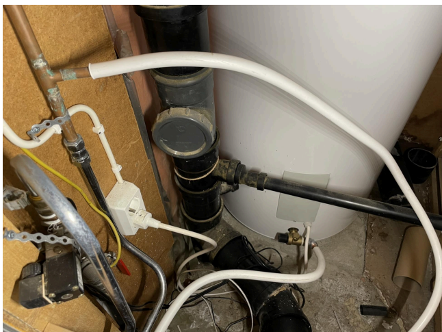
Stakeluke og varmtvannsbereder plassert i lukket rom bak toalett på bad kjeller.
