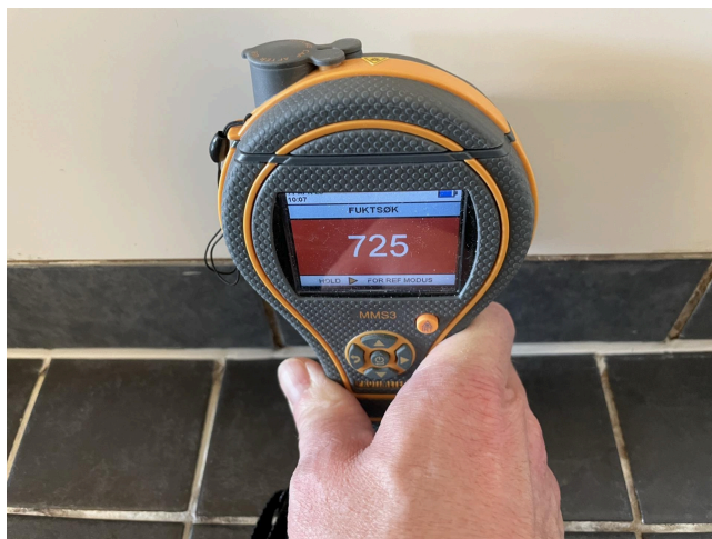
Det er målt med fuktindikator. Full utslag på fukt.
