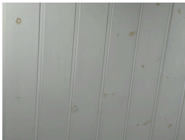
Det registreres misfarging i trepanel.
