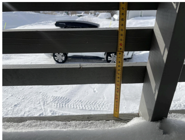
Rekkverk på balkong utenfor soverom har ikke høyde eller utforming som tilfredsstillers dagens krav.
