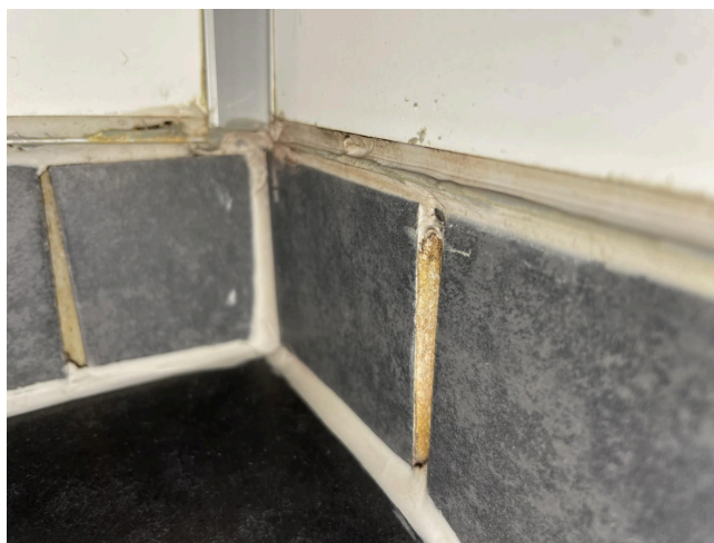
Våtromsplatene er ikke forseglet tilstrekkelig i nederkant.
