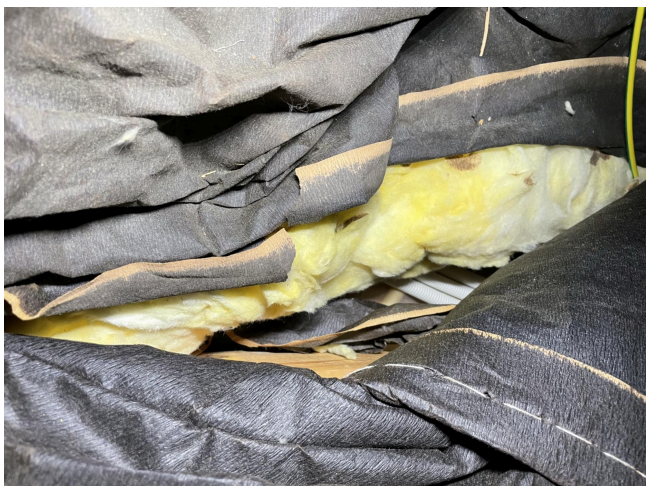
Taket er dårlig isolert.
