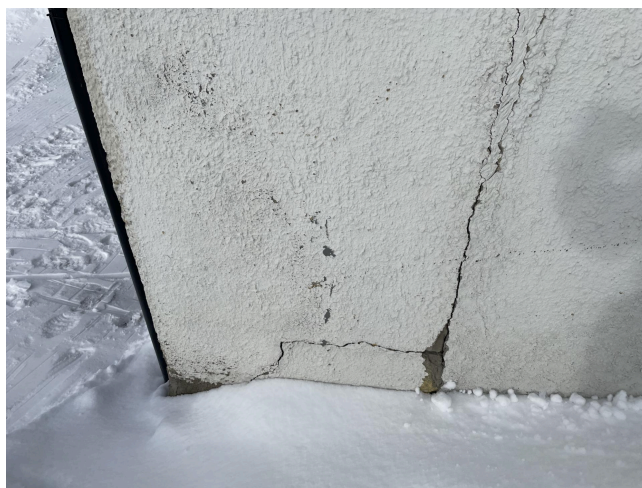
Avflassing og riss i overflate mur. Skrå og vertikale sprekker i murpuss påvist.
