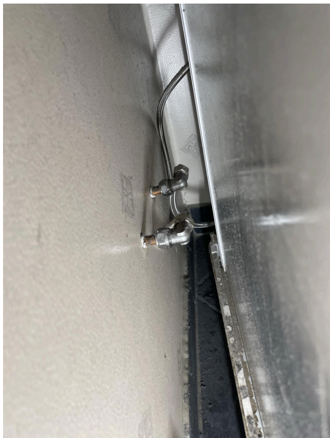
Gjennomføringer i våtsone vegg vask og dusjsone er ikke korrekt utført.
