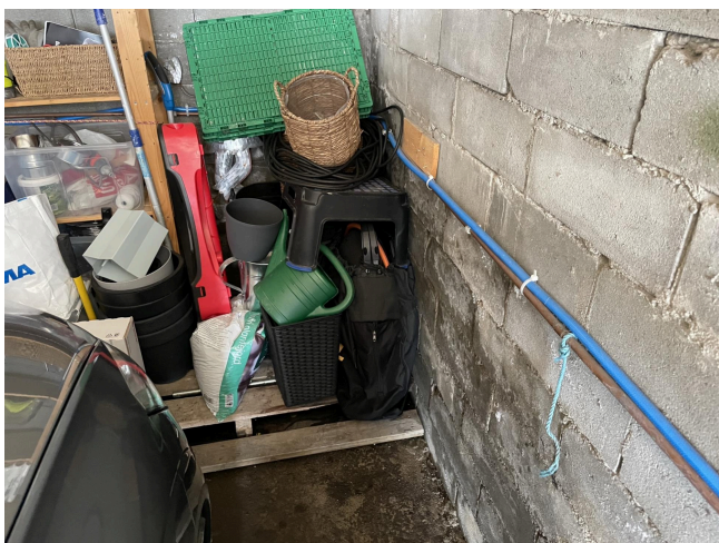
Det registreres fuktflekker på innvendig veggflate mur.
