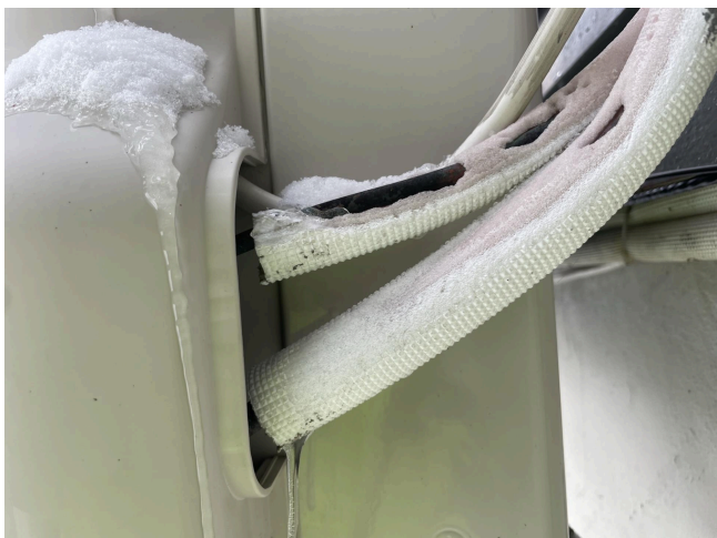
Det er skade på kondensisolasjonen til rørføringer fra luft-til-luft varmepumpen.
