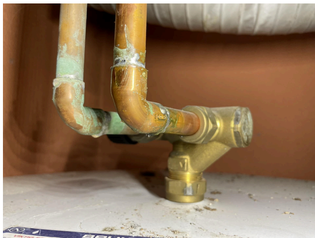
Vannrør av kobber har synlig eiring.
