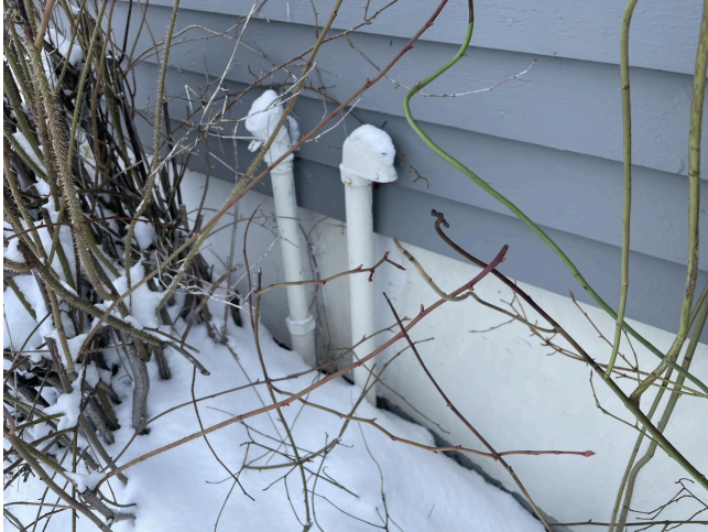
Oljetank er ikke i bruk og har ingen dokumentasjon.
