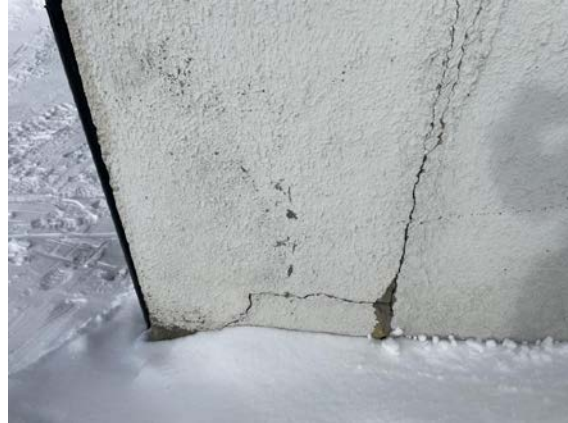
Avflassing og riss i overflate mur. Skrå og vertikale sprekker i murpuss påvist.
