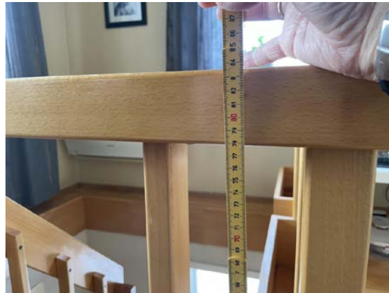
Høyde av rekkverk ikke iht. krav.
