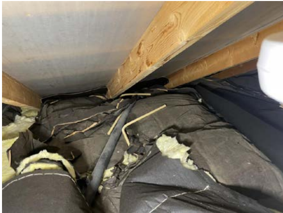
Taket er dårlig isolert.
