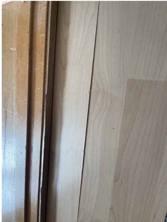
Løse skjøter på langside laminat.
