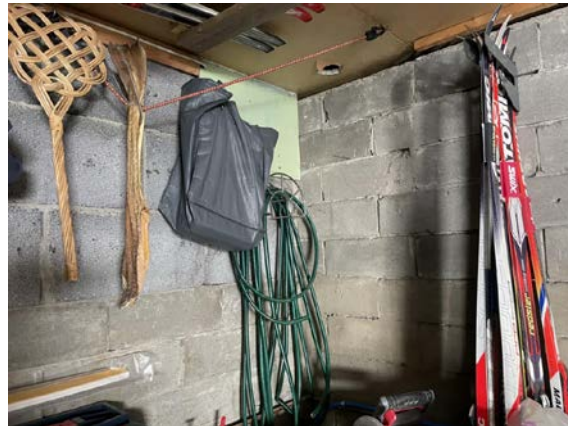
Lecavegg i garasje har manglende overflatebehandling.
