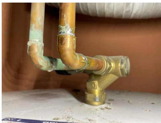
Vannrør av kobber har synlig eiring.
