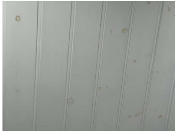
Det registreres misfarging i trepanel.
