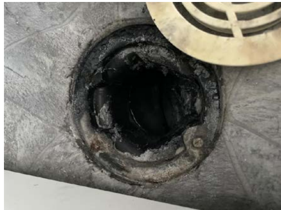
Våtrommets tettesjik/ membran på gulv står foran utbedring/ utskifting.
