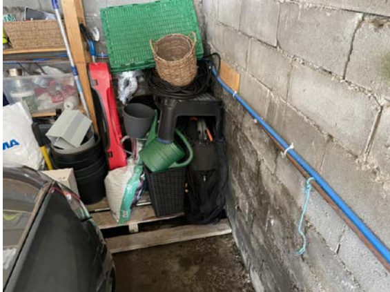
Det registreres fuktflekker på innvendig veggflate mur.
