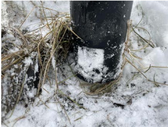
Bortledning av vann fra nedløp ikke tilfredsstillende.
