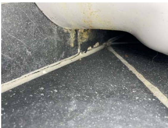
Oppsprukket fug mellom gulvflis og sokkelflis.
