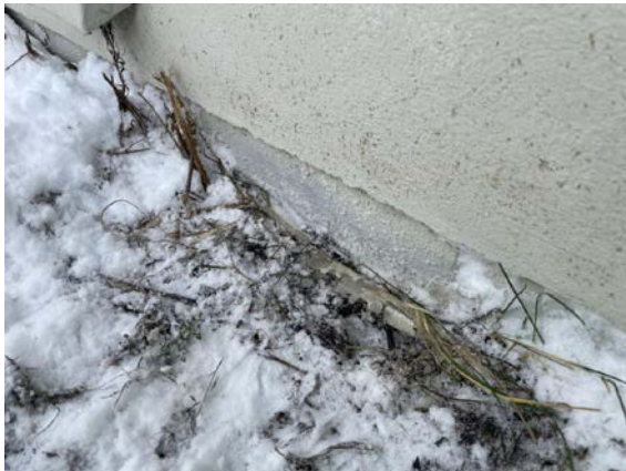
Det mangler kapillærbrytende sjikt på konstruksjon mot terreng.
