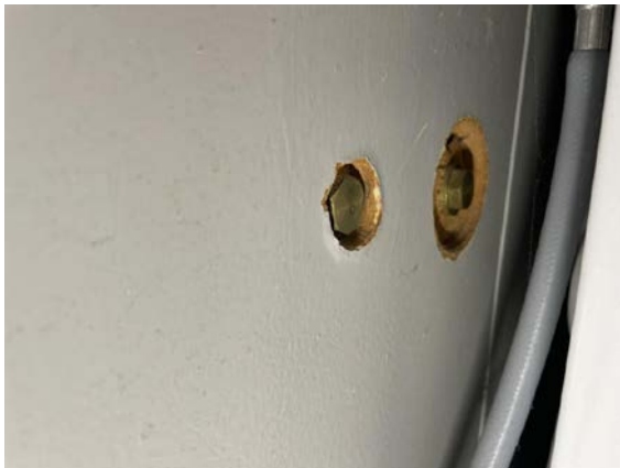
Våtsone vegg er ikke etablert. Gjennomføringer i våtsone vegg er ikke korrekt utført.
