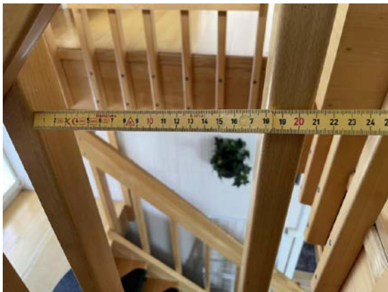
Åpninger i rekkverk ikke iht. krav.
