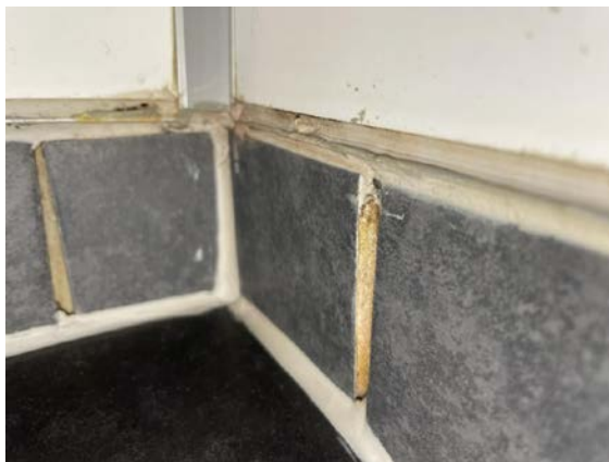
Våtromsplatene er ikke forseglet tilstrekkelig i nederkant.
