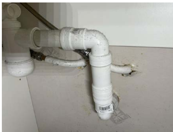
Gjennomføringer i våtsone vask og dusjsone er ikke korrekt utført.
