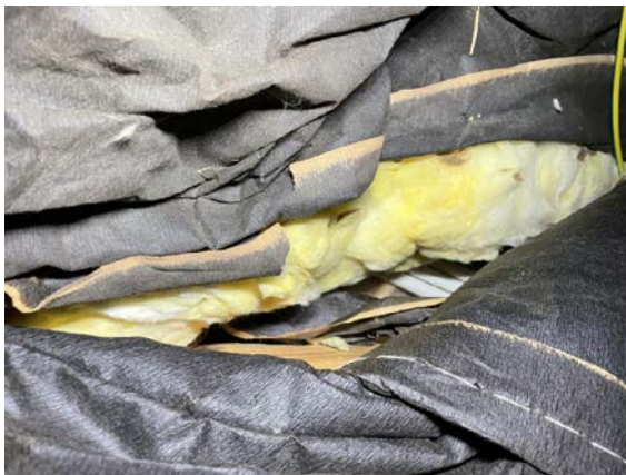
Taket er dårlig isolert.
