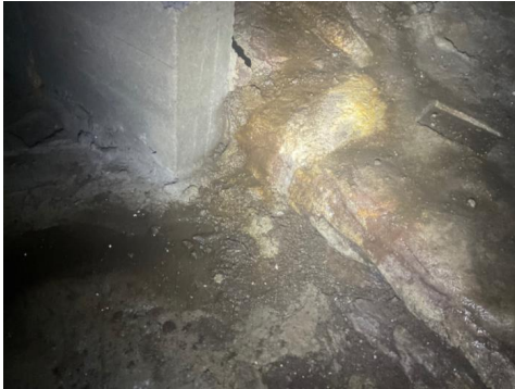
Tilsig av vann under grunnmur
