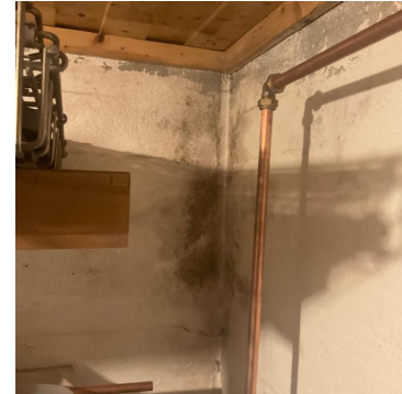
Maling flasket i bod grunnet fuktoptak i mur.
