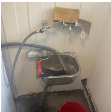
Utslagsvask på vaskerom
