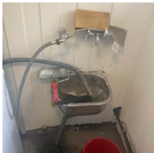
Utslagsvask på vaskerom
