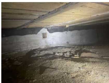
Ventiler i tørr krypkjeller
