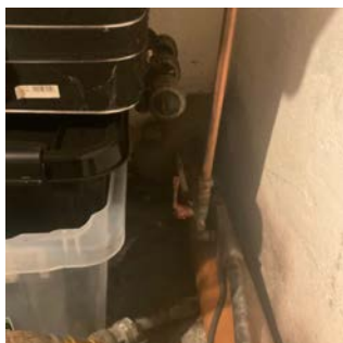
Stoppekran i bod kjeller.
