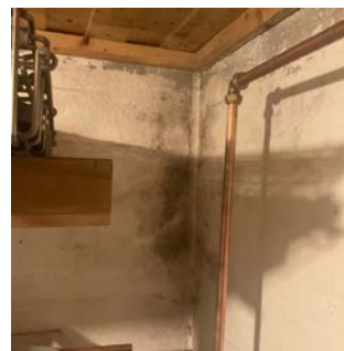
Maling flasket i bod grunnet fuktopptak i mur.
