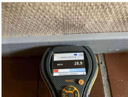
Høyt fuktinnhold i listverk trapperom 1.etg.
