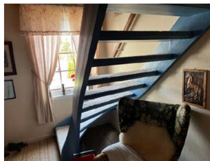
Manglende rekkverk, krypsikring og håndløper på vegg.
