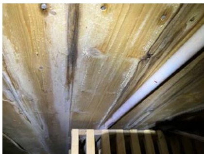
Synlig råte og sopp i panel
