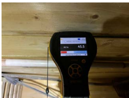
Stående vann i treverk.
