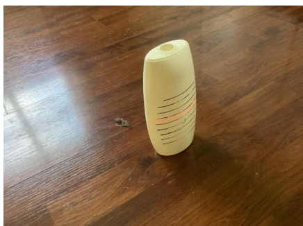
Kjøkken. Overflateavvik ca 18 mm.
