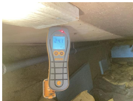
Ved fuktmåling målte jeg risikable verdier for skadelig fukt, dette indikerer at konstruksjonen er utsatt for fuktpåkjennning.
