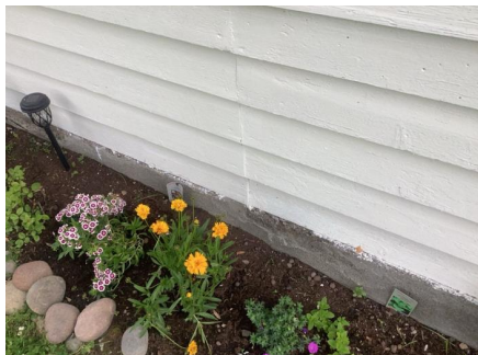
Panel går helt ned på grunnmur uten beslag.
