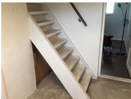
Kjellertrapp mangler rekkverk.
