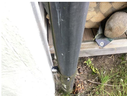
Frostspreng på takrennenedløp.
