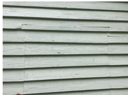
Panel med slitasje.
