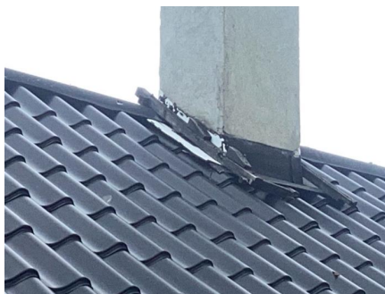
Folie eller malingsflass ble registrert. Pipehatt og mønebeslag.
