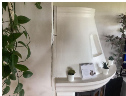
Sprekk mellom peis og pipeløp.
