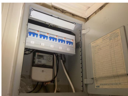
Sikringskap i entre.
