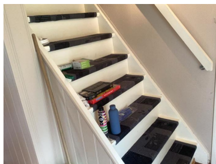
Loftstrapp mangler rekkverk.
