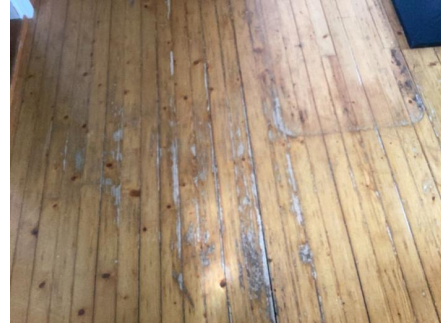
Slitasjeskader på gulv.
