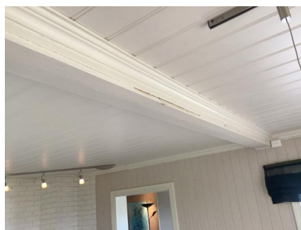
Vannskade i tak under veranda.
