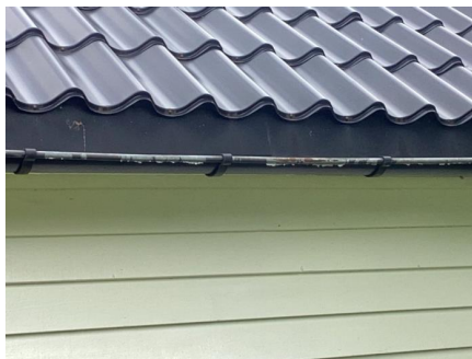
Folie eller malingsflass ble registrert. Takrenner og rennebeslag.
