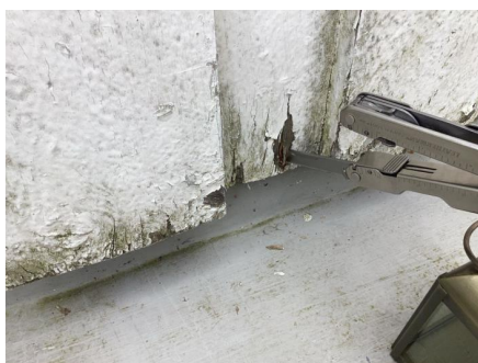
Råteskadet panel på rekkverk.
