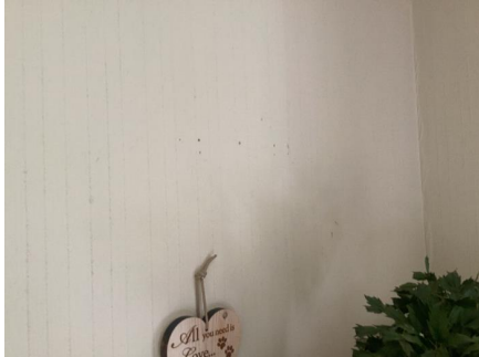
Hull i vegger etter tidligere installasjoner. Soverom.
