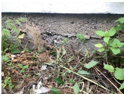
Riss og sprekker registrert på grunnmur.
