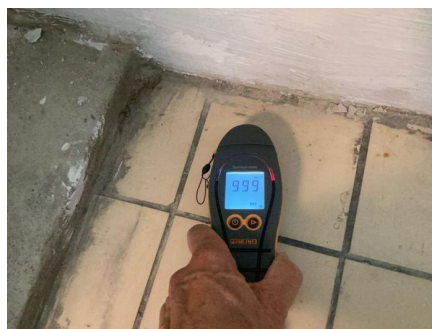
Gulv. Ved enkle fuktsøk ble det registrert områder med unormale verdier.
