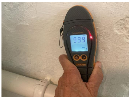
Vegg. Ved enkle fuktsøk ble det registrert områder med unormale verdier.
