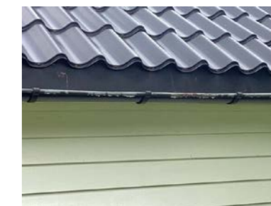
Folie eller malingsflask ble registrert. Takrenner og rennebeslag.
