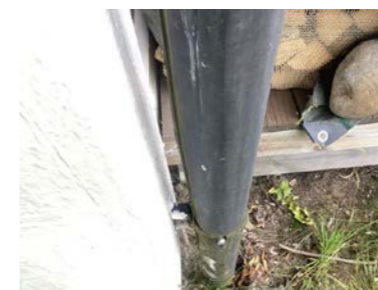
Frostspreng på takrennenedløp.
