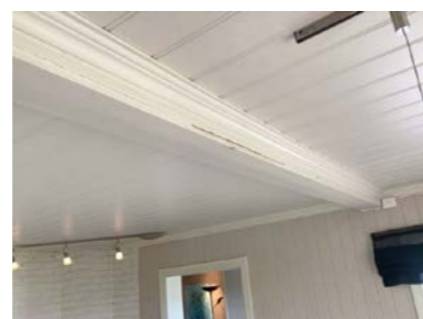
Vannskade i tak under veranda.
