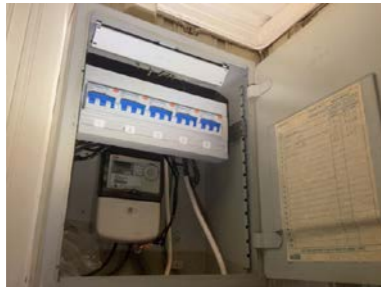
Sikringsskap i entre.
