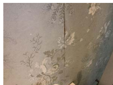
Løs tapet på fiberplater i dusjhjørne.
