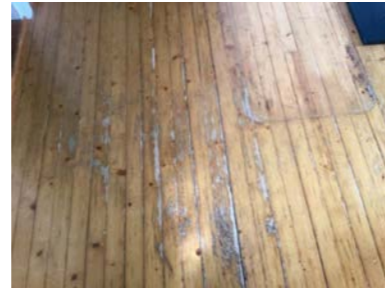
Slitasjeskader på gulv.
