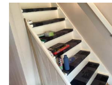
Loftstrapp mangler rekkverk.
