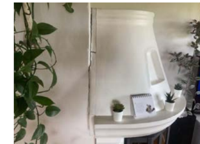
Sprekk mellom peis og pipeløp.
