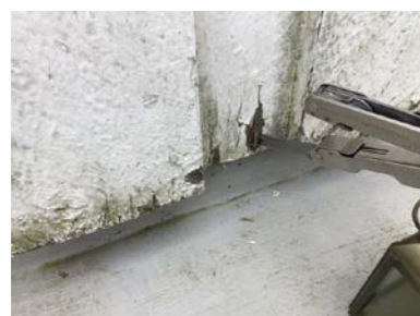
Råteskadet panel på rekkverk.
