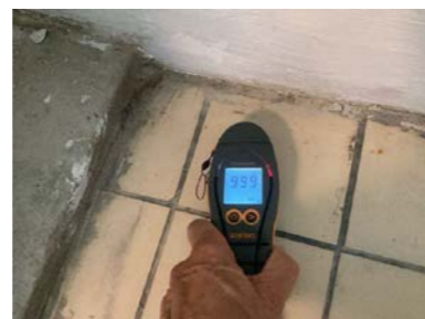
Gulv. Ved enkle fuktsøk ble det registrert områder med unormale verdier.
