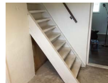
Kjellertrapp mangler rekkverk.
