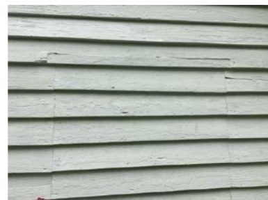
Panel med slitasje.
