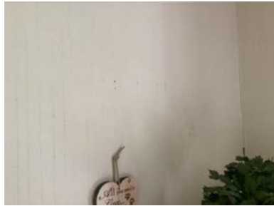
Hull i vegger etter tidligere installasjoner. Soverom.
