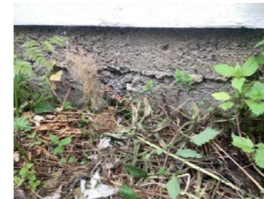
Riss og sprekker registrert på grunnmur.
