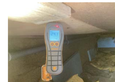
Ved fuktmåling målte jeg risikable verdier for skadelig fukt, dette indikerer at konstruksjonen er utsatt for fuktpåkjenning.
